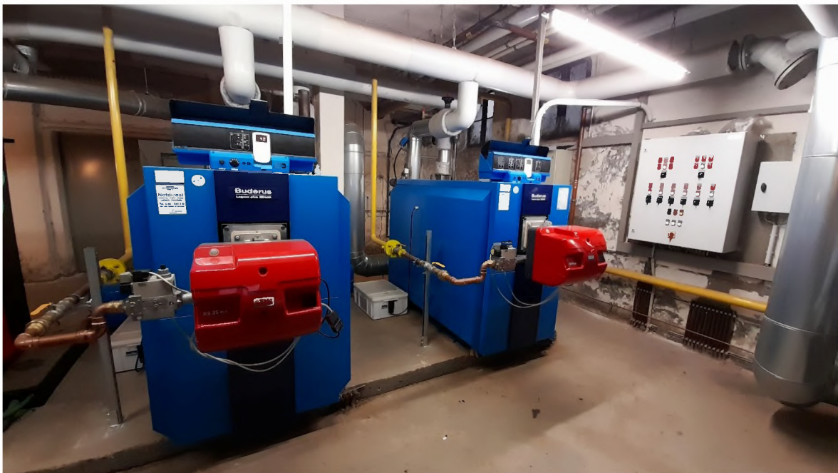
Abbildung 10: Aufnahme Heizungskeller Gebäude 07, Quelle: FRANK
