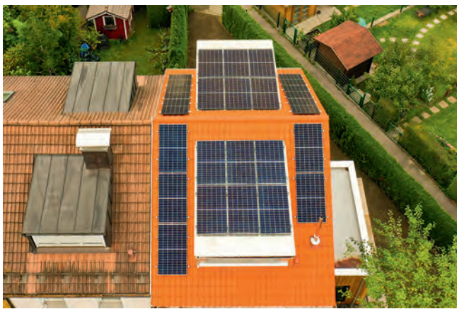
Bild 7: Vogelperspektive mit Blick auf die PV-Anlage [Quelle: Grübl]
