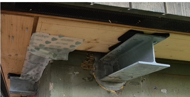
Abb. 6: Eingebundene Stahlträger (HEA)
